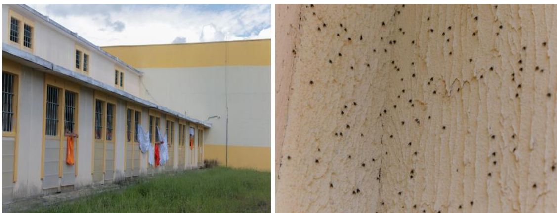
Figura 22 – Foto do escoamento de água e da infestação de insetos na unidade penal
